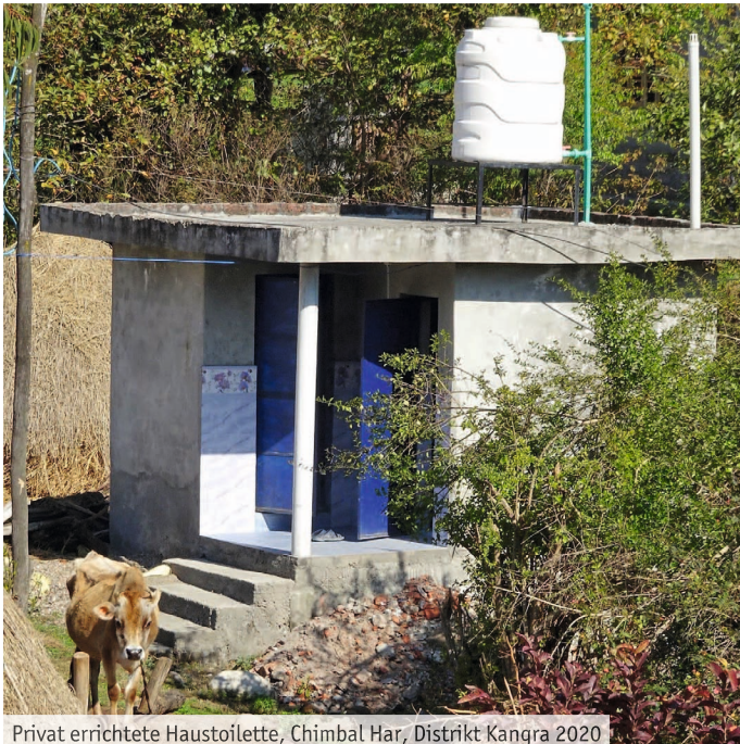
Privat errichtete Haustoilette, Chimal Har, Distrikt Kangra 2020
