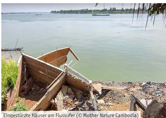
Eingestürzte Häuser am Flussufer (© Mother Nature Cambodia)
