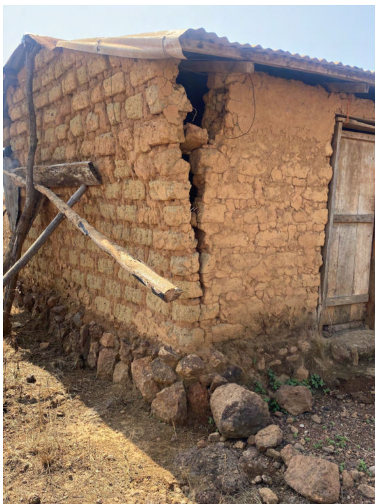
Riss in der Außenwand eines Hauses
