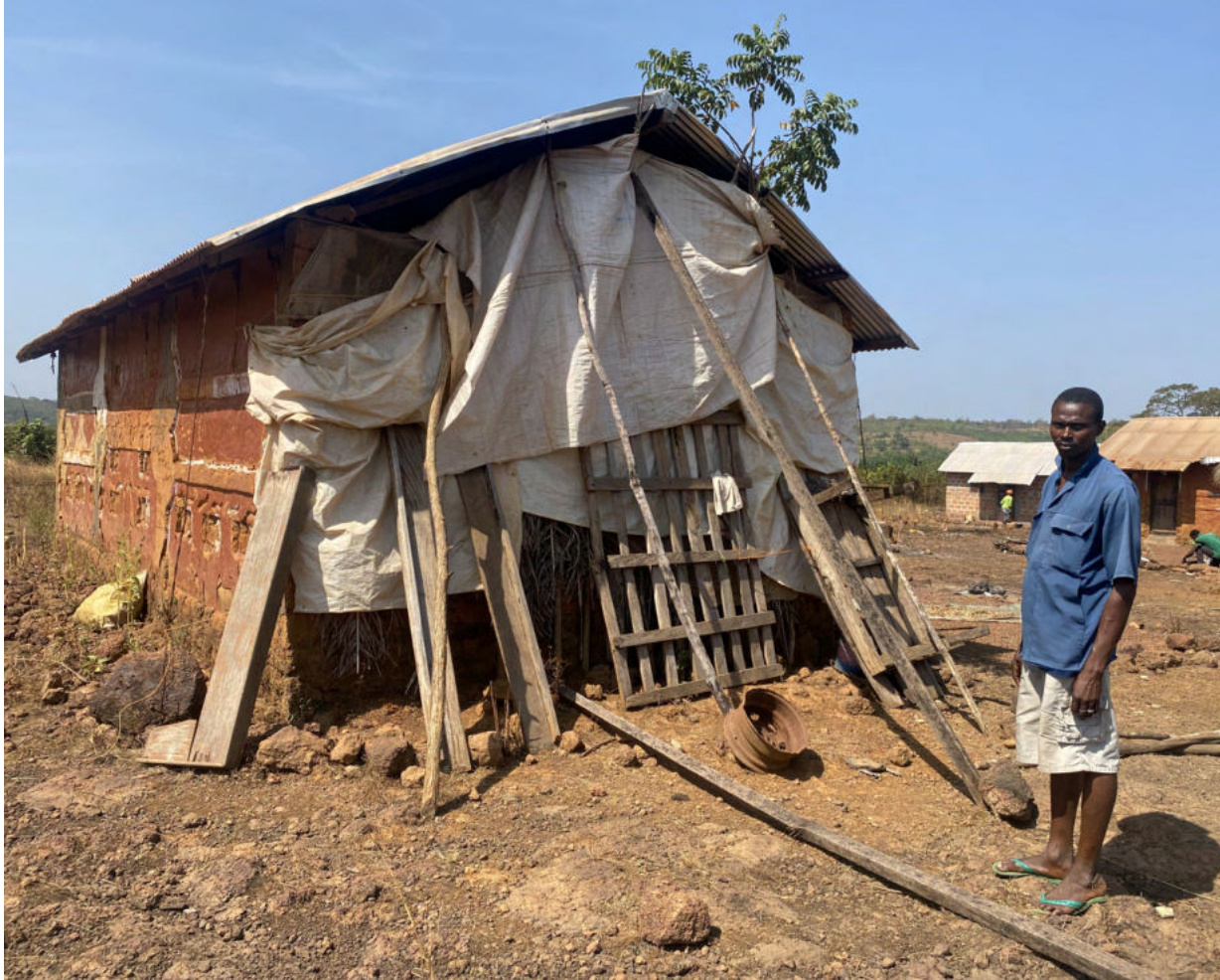
Eingestürzte Hauswand in Bouroré
